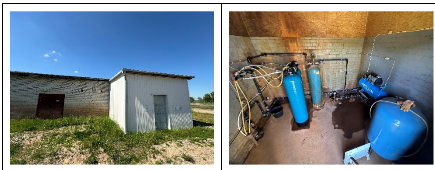
Fotod 4.8 Kaagjärve Keskuse veetöötlusjaam 2024. aastal.
