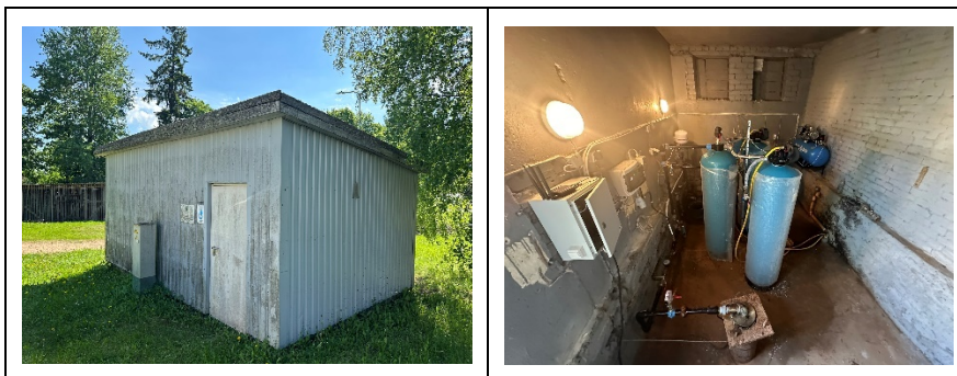
Fotod 4.5 Lüllemäe Elamute veetöötlusjaam 2024. aastal.
